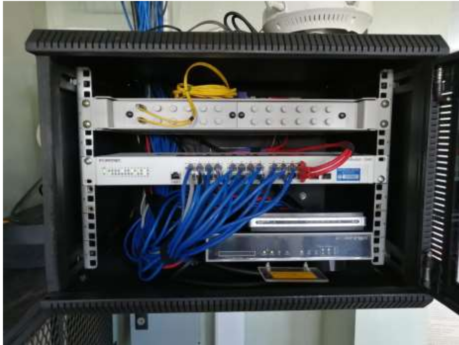
Figura #7. Gabinete de Comunicaciones Guápiles.
