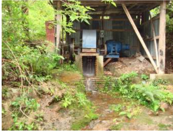
Foto 17. Generador de electricidad de la paja del hotel Guachipelín.
